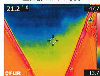
室外機下からのサーモグラフ
